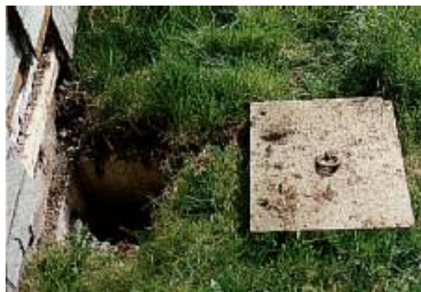
Photo 3 : dalle de béton déplacée et revêtement extérieur arraché par le passage de la foudre (photo Alex Hermant).
